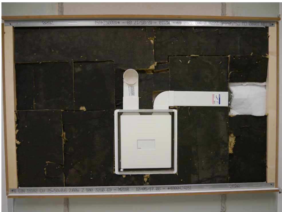
Abbildung B.12. Einbauvariante U 2 : Raumseitige Ansicht Lüftungsgerät mit montierten Lüftungskanälen für Variante Zwei-Raum-Einbau ZUL-seitig; Zustand vor dem Schließen der Vorsatzschale.
