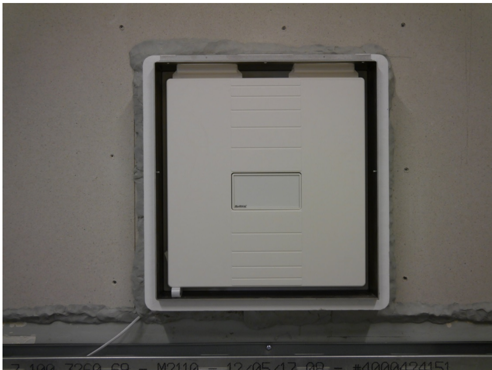
Abbildung B.6. Einbauvariante U 2 : Raumseitige Ansicht Lüftungsgerät vor Montage der Vorsatzschale, Abdichtung zum Prüfstand vollständig.
