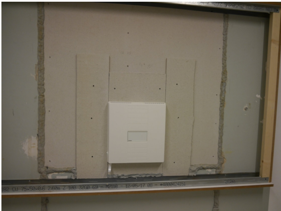
Abbildung B.16. Einbauvariante M-WRG-M (-MB) UP-Standard: Raumseitige Ansicht Lüftungsgerät mit Gerätedeckel (prüffertig).
