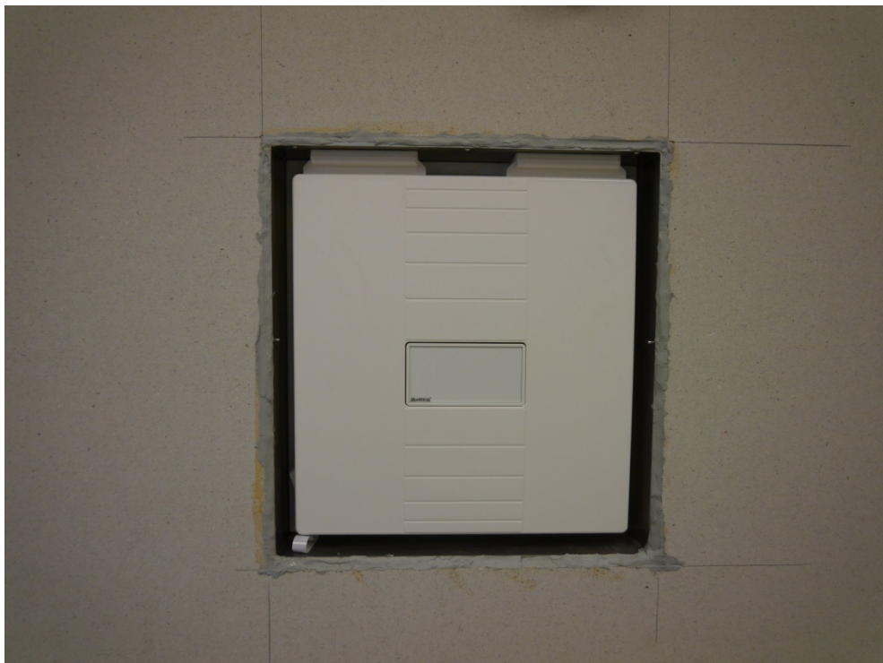
Abbildung B.10. Einbauvariante U 2 : Raumseitige Ansicht Lüftungsgerät nach Montage der Vorsatzschale.
