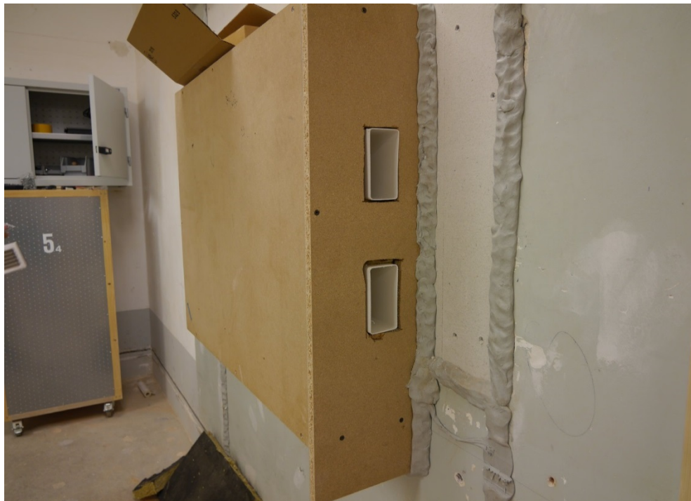
Abbildung C.4. Variante Fensterlaibungslösung: Außenseitige Lüftungsöffnungen in der nachgebildeten Fensterlaibung (Außenluft oben, Fortluft unten), Fassadenabschluss noch nicht montiert.
