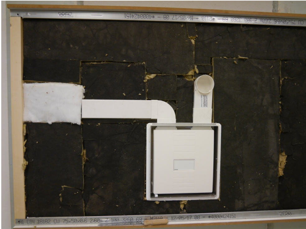
Abbildung D.9. Ansicht Lüftungsgerät innenseitig mit montierten Lüftungskanälen für Variante Zwei-Raum-Einbau ABL-seitig; Zustand vor dem Schließen der Vorsatzschale.
