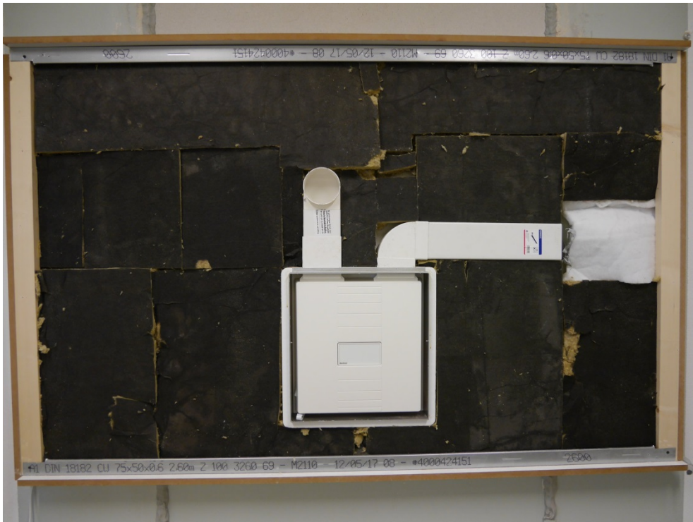
Abbildung D.11. Ansicht Lüftungsgerät innenseitig mit montierten Lüftungskanälen für Variante Zwei-Raum-Einbau ZUL-seitig; Zustand vor dem Schließen der Vorsatzschale.
