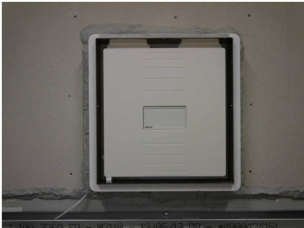
Abbildung D.4. Ansicht Lüftungsgerät innenseitig vor Montage der Vorsatzschale, Abdichtung zum Prüfstand vollständig.
