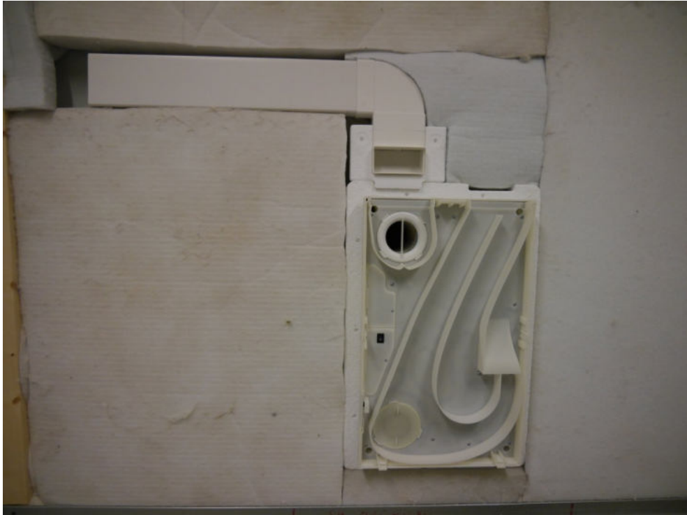
Abbildung B.15. Lüftungsgerät nach Montage in der Trockenbaublende, UP-Einbau mit Kanalanschluss ABL-seitig, Gerätedeckel entfernt, ABL-Kanal in der Vorsatzschale endend, Vorsatzschale gedämmt aber noch ohne Beplankung.
