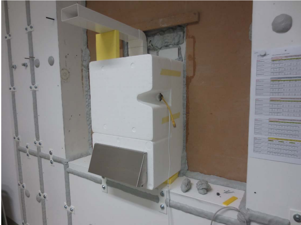
Abbildung E.5. Mehr-Raum-Variante mit Kanalanschluss ZUL-seitig: Ansicht Außenseite (prüffertig). Kanalanschluss ZUL nach außen (Senderraum) geführt.
