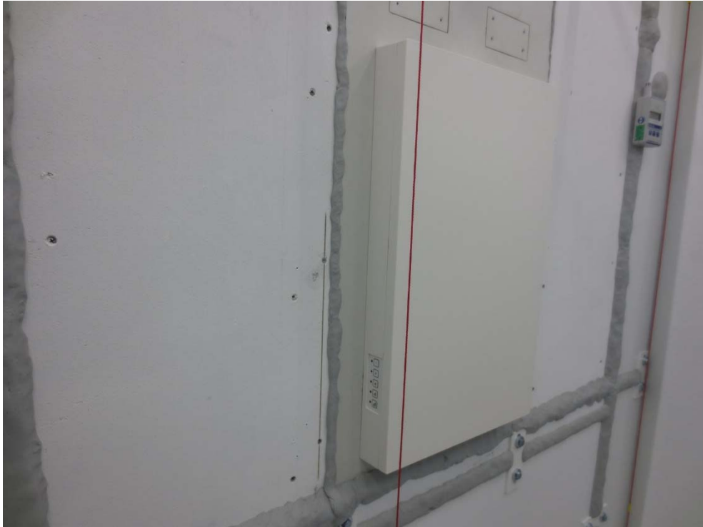
Abbildung E.9. Ein-Raum-Variante: Ansicht Innenseite links (prüffertig).
