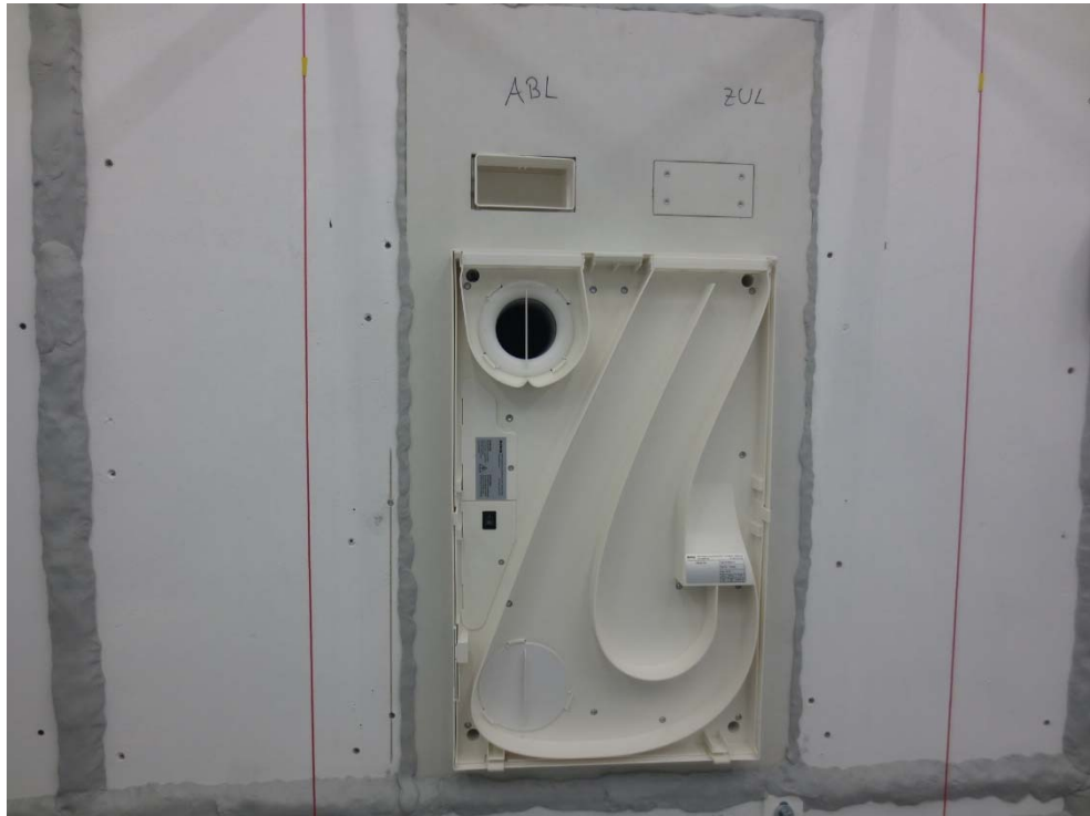
Abbildung E.11. Mehr-Raum-Variante während der Montage: Lüftungsgerät geöffnet, Kanalanschluss durch Trockenbaublende geführt (hier: Variante mit Kanalanschluss ABL-seitig).
