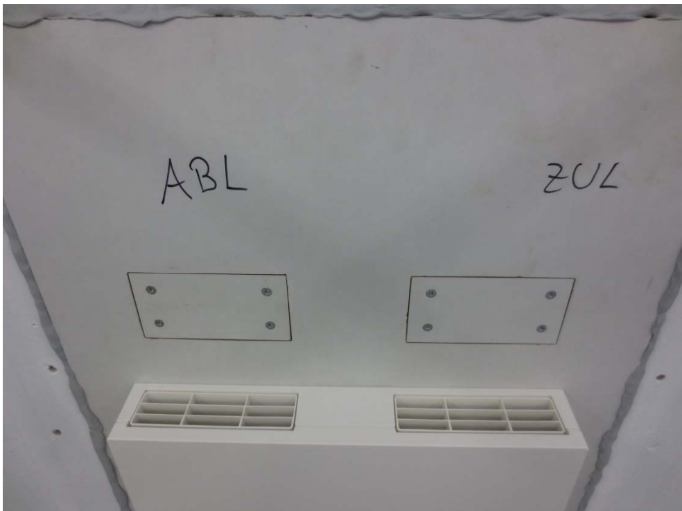
Abbildung E.10. Ein-Raum-Variante: Ansicht Innenseite oben mit Lüftungsöffnungen ABL links und ZUL rechts (prüffertig).
