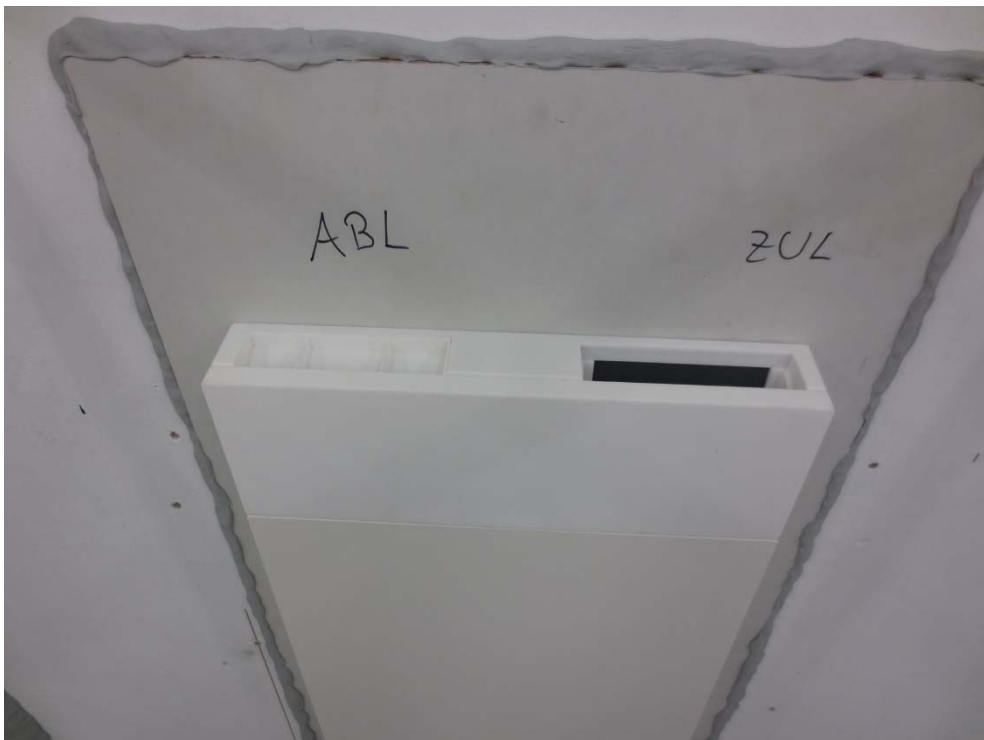
Abbildung E.16. Mehr-Raum-Variante mit Kanalanschluss ABL-seitig: Ansicht Innenseite oben mit geöffneter ZUL-Öffnung (prüffertig).
