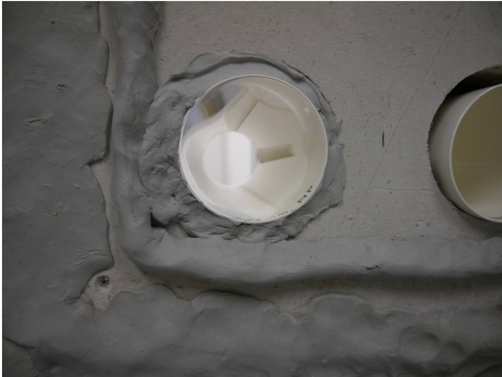
Abbildung B.3. Durchführung der Lüftungsrohre zu den Außenöffnungen durch die Trockenbaublende im Fensterprüfstand; links mit umlaufender Abdichtung, rechts noch ohne Abdichtung.
