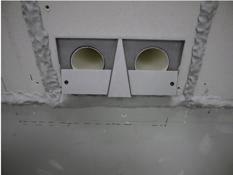
Abbildung B.5. Lüftungsöffnungen außenseitig mit teilweise montiertem Fassadenabschluss (Wandhalterung der Edelstahlscote).
