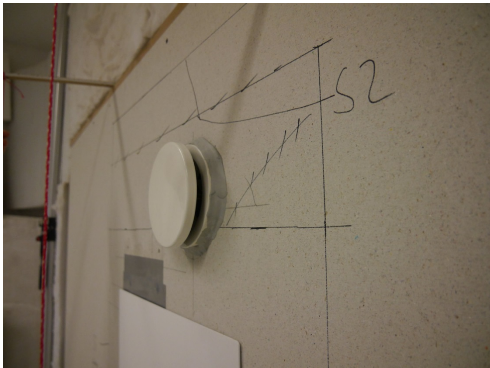
Abbildung B.10. U 2 -Einbau mit Kanalanschluss ABL-seitig prüffertig im Fensterprüfstand: Detailansicht Tellerventil ZUL fertig montiert.
