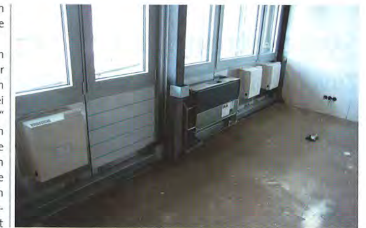
In der Regel kamen pro Raum drei Lüftungsgeräte zum Einsatz
