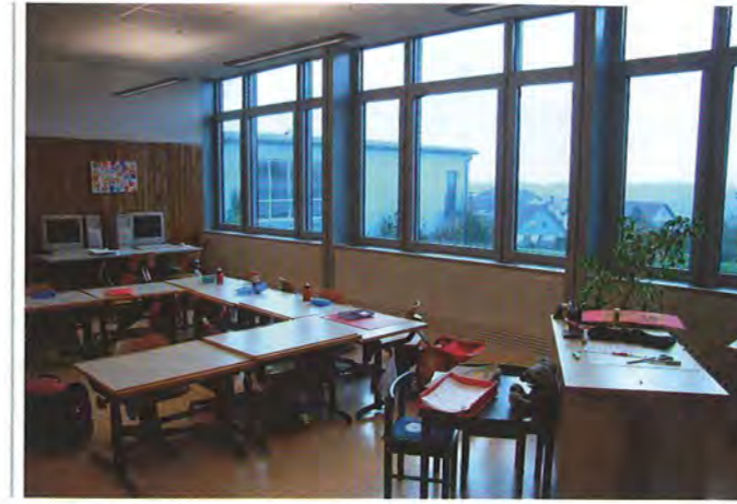
Alle Klassenzimmer erhielten eine moderne dezentrale Belüftungsanlage mit Wärmerückgewinnung
