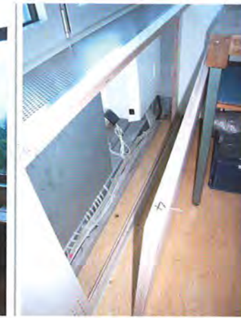
Die Lüftungsgeräte wurden unter den Fenstern in die Außenwände integriert
