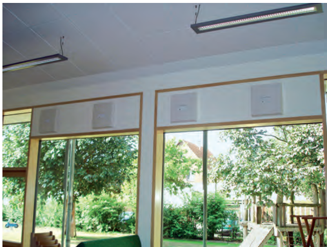
Bild 3. Großflächige Fenster lassen viel Tageslicht herein; oberhalb der Fenster sind die Lüftungsgeräte angeordnet
