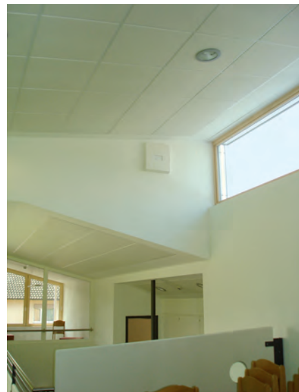
Bild 2. Das Innere der Kindertagesstätte wird durch Treppen und Galerien gegliedert; unterhalb der Dachschräge ist ein Lüftungsgerät zu sehen
