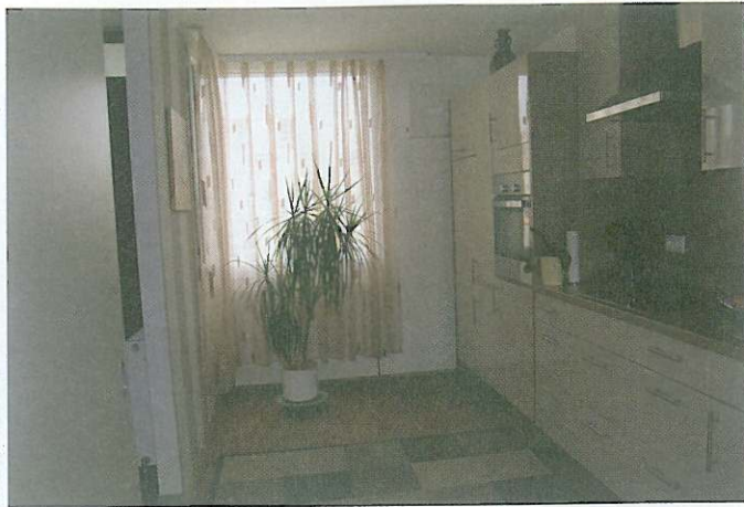
Bild 2: Einzelne Räume wurden mit einer dezentralen Lüftungsanlage von Meltem ausgestattet, die in Deckennähe direkt neben den Fenstern eingebaut wurde
