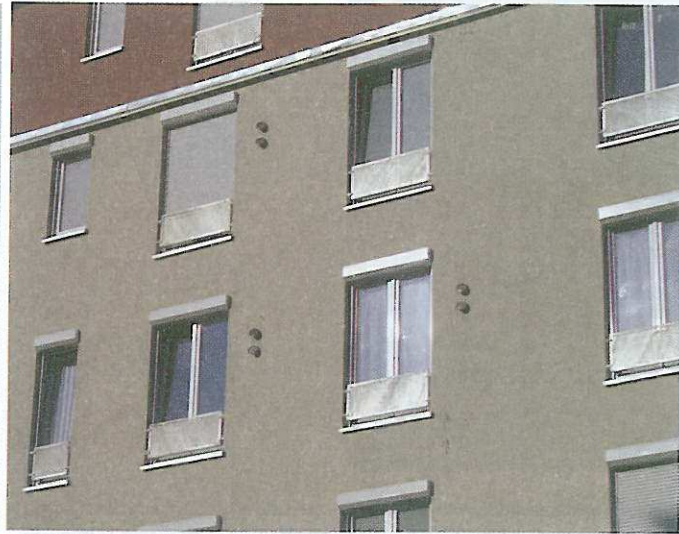
Bild 2: Die Zu- und Abluftstutzen der Geräte wurden komplett in die Fassadengestaltung integriert
