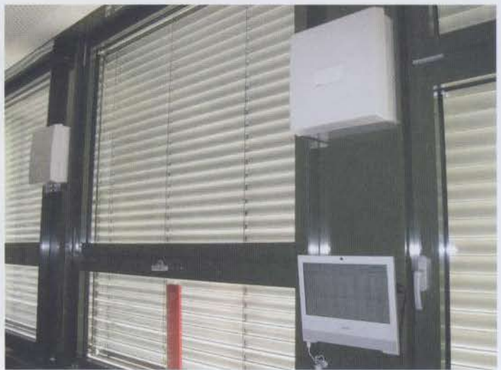
Mit dem Touch-Screen lassen sich die Lüftungsgeräte in jedem Klassenraum separat ansteuern
